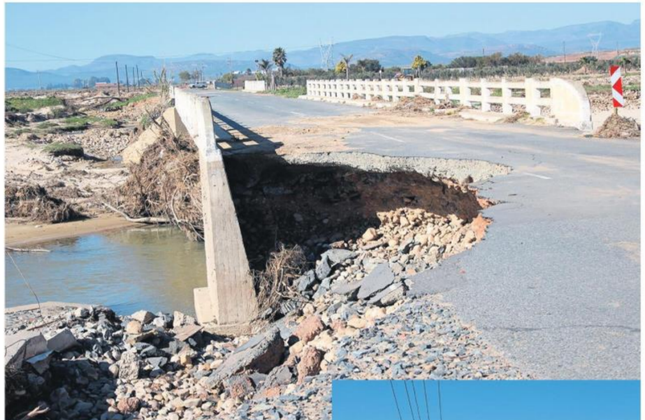
The damage to the Aan De Doorns Road
