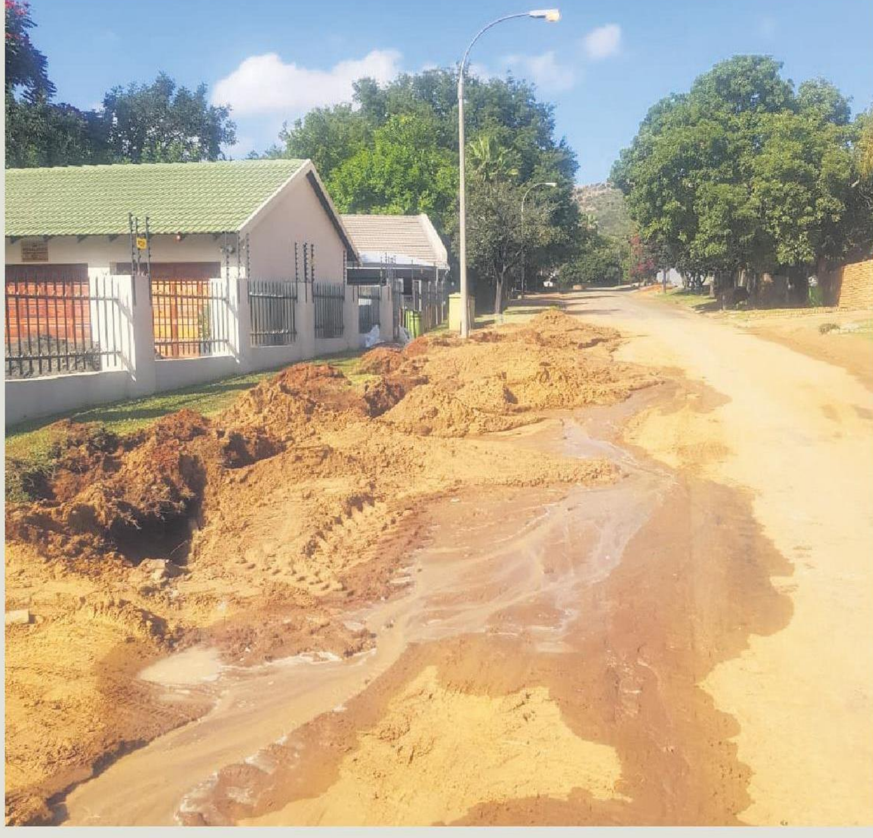
Slote wat die Rustenburg-munisipaliteit in Frangipanistraat grawe het wat glo skade veroorsaak en veiligheidsrisiko's inhou.
